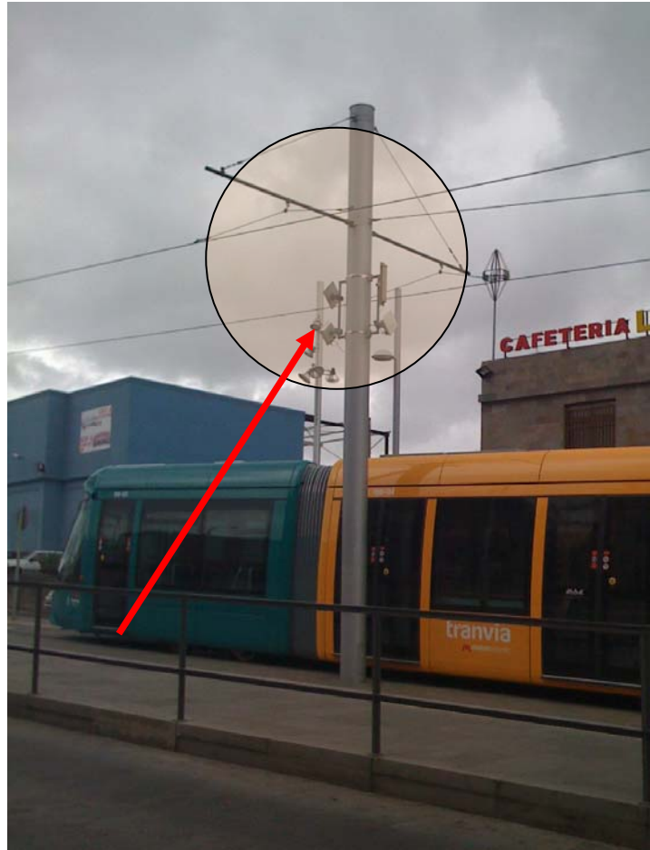
Крепление базовых станций Proxim MP.11 на опорах
